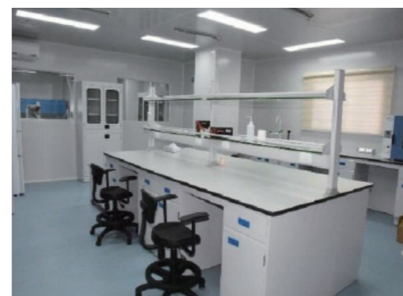
甘肃省陇南市公安局实验室建设项目中央空调、通风及净化工程
